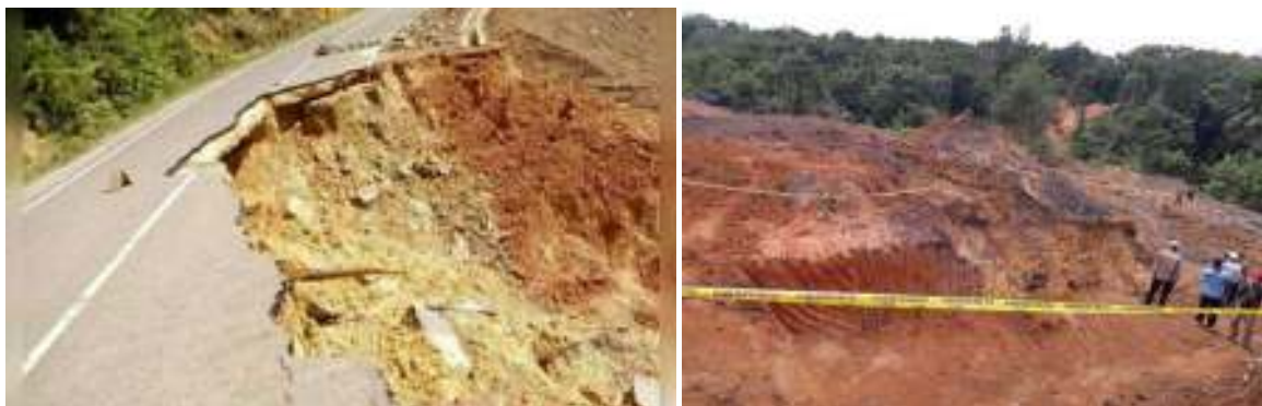
Gambar 3-42 Bencana Longsor di Kalteng (Dijalan dan Lokasi Penambangan Masyarakat)
